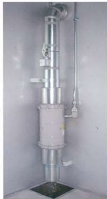
防火ダンパー中間ダクトファン
